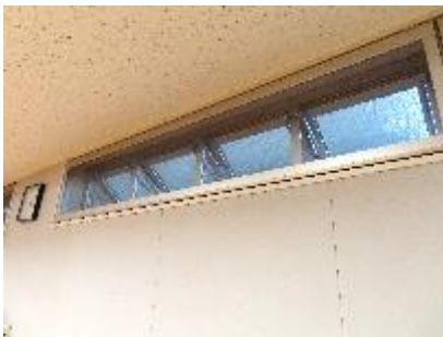
窓(排煙用) ロビー・楽屋・練習室 開閉可能
